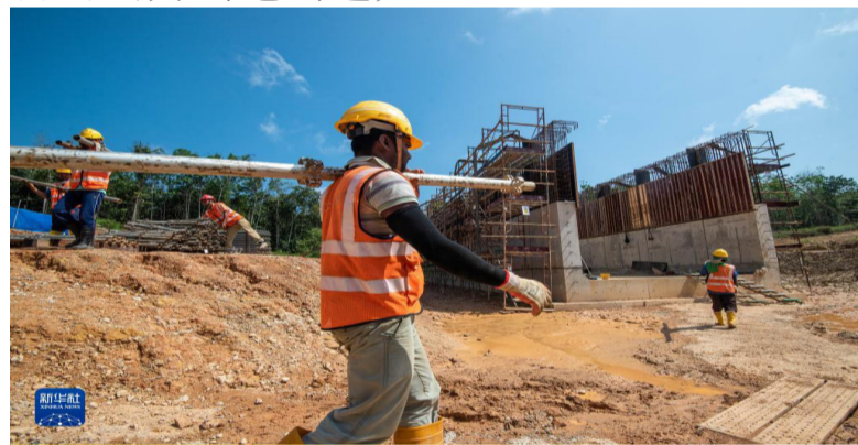
3月6日，工人在马来西亚彭亨州金马梳的马来西亚东海岸铁路（马东铁）沿线施工。新华社发（张纹综摄）
