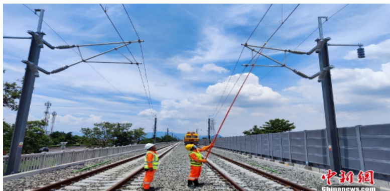
图为中国中铁电气化局雅万高铁项目接触网工作人员进行验电作业。中新社发 李培养 摄
