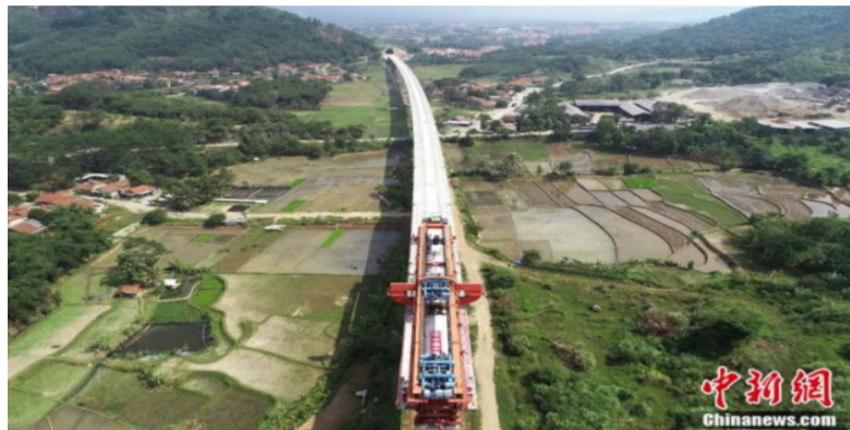
2022年9月7日，施工中的印尼雅万高铁，这是“一带一路”建设和中印尼两国务实合作标志性项目。王增堃 摄
