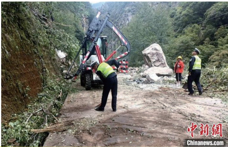
交警和救援力量正在疏通受损道路。 甘孜州公安局供图
