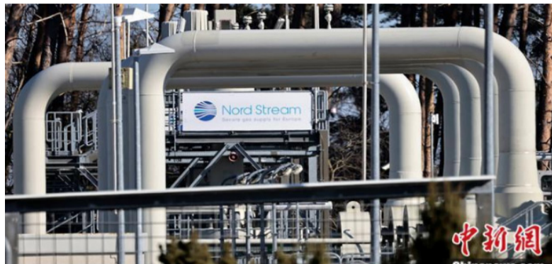
资料图：“北溪-1”天然气管道。
