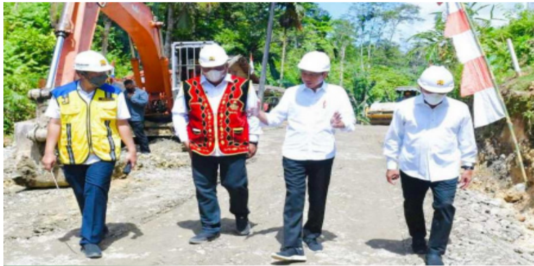
2022年7月6日，星期三，北苏门答腊岛北Nias县，总统佐科维视察改善Laehuwa-Ombolata-Tumula-Faekhuna'a公路结构的项目。
