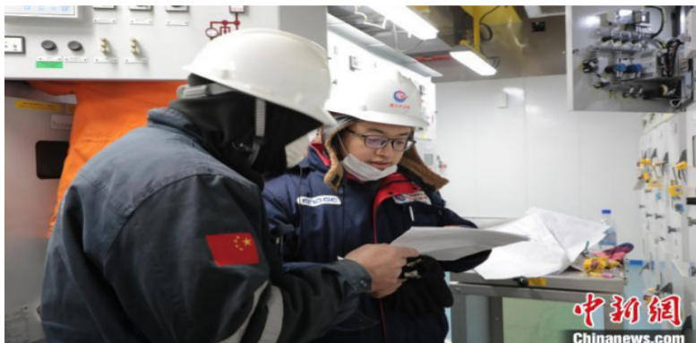
2021年1月1日，青年员工正在高压配电间逐一核对接电线路。中国海油海南分公司供图
