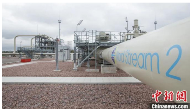
“北溪二号”在俄罗斯境内的管道设施。中新社发 北溪二号公司 供图
