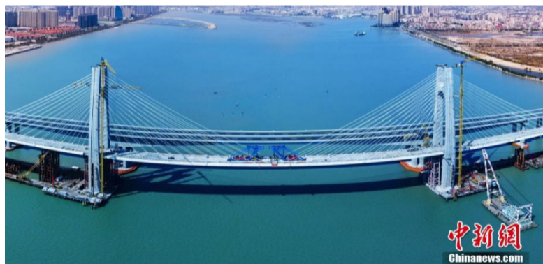
4月6日,中国首条跨海高铁——福(州)厦(门)高铁安海湾特大桥梁成功合龙。该桥是中国高铁建设中首次在跨海斜拉桥中铺设无砟轨道,实现高铁桥梁最高行车时速350公里。图为4月5日,航拍安海湾特大桥梁。(无人机照片) 中新社发 张伟 摄
