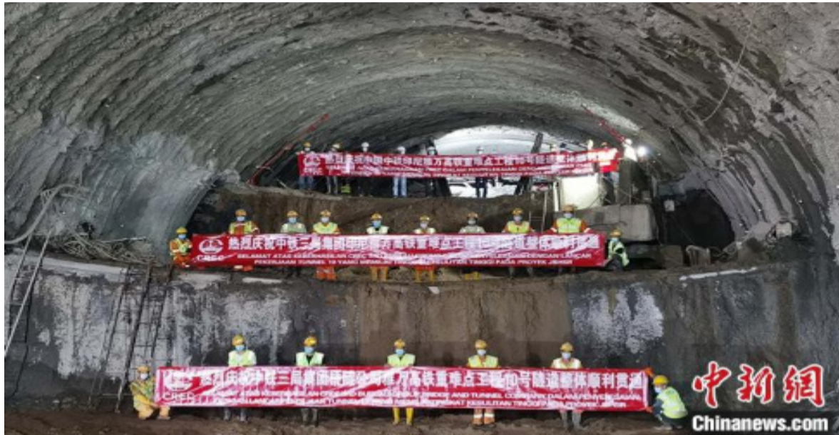
当地时间8月8日，印尼雅万高铁8号隧道实现全隧贯通。这是继两天前10号隧道贯通后，雅万高铁完成的又一重要控制性工程。图为8月6日，工作人员手持横幅庆祝10号隧道顺利贯通。中新社发 陈波 摄
