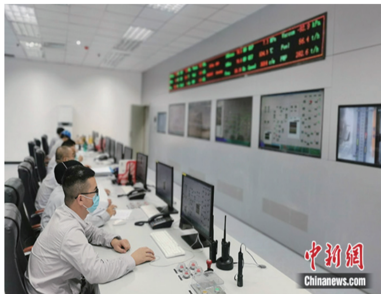
图为电站集控室。中新社发 魏文刚 摄
