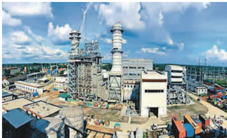
图为一带一路中，中国能源建设公司建设的孟加拉古拉绍电站。钟能建摄
