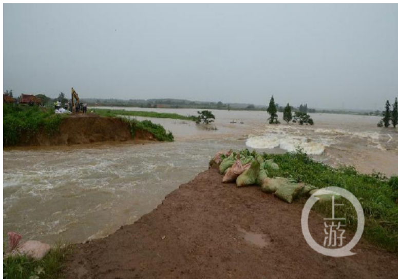
7月9日，南昌市新建区大塘坪乡发生赣江支流蚂蚁河新培圩堤溃口，溃口长度近30米，周边13000亩农田受灾。图片来源/南昌市警备区
